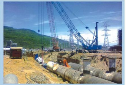
Lắp hệ thống ống tuần hoàn Nhà máy Nhiệt điện Nghi Sơn 1 Installation of CW Pipeline system for Nghi Son 1 Thermal Power Plant
